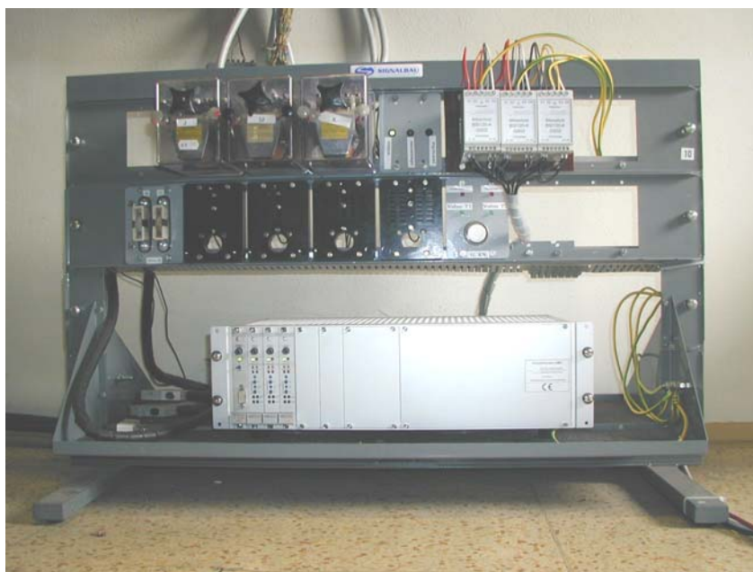
Obr. 9: Ověřovaný počítač náprav s výstupními relé a komparačním obvodem
