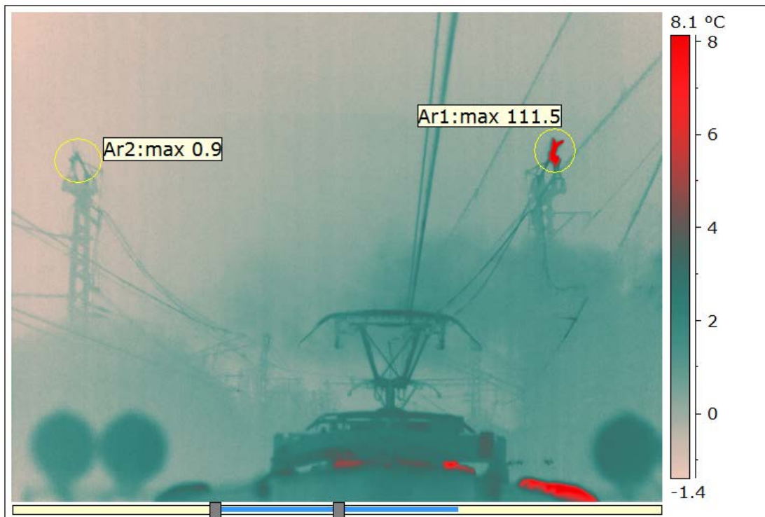
Obr. 9.1: porucha úsekového odpojovače
