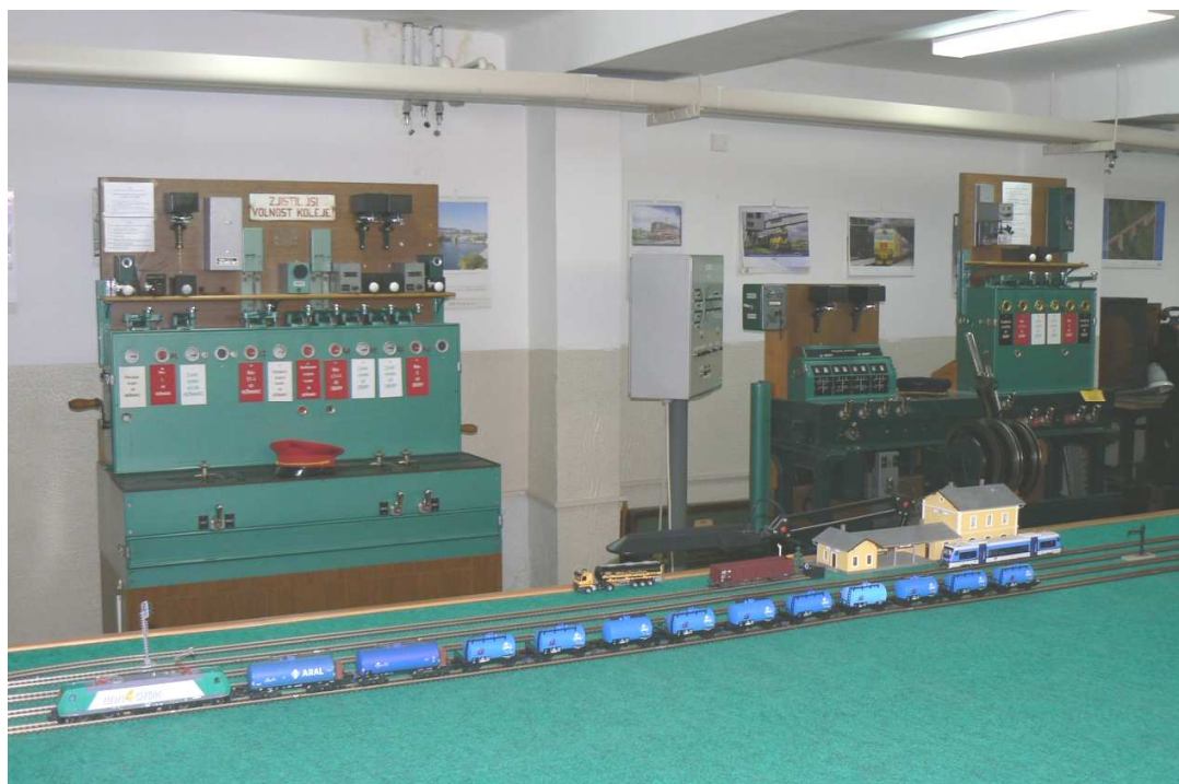
Obrázek 3 - Elektromechanické zabezpečovací zařízení v DS (Zdroj: autoři)
