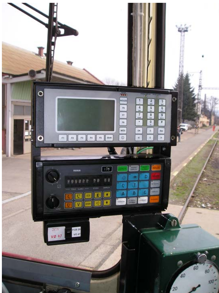
Obr. č.5 Digitální traťový systém DTS – ovládací skříňka vozidlové radiostanice FXM 20 umístěná při ověřovacím provozu na vozidle řady 810 nad standardní ovládací skříňkou TRS
