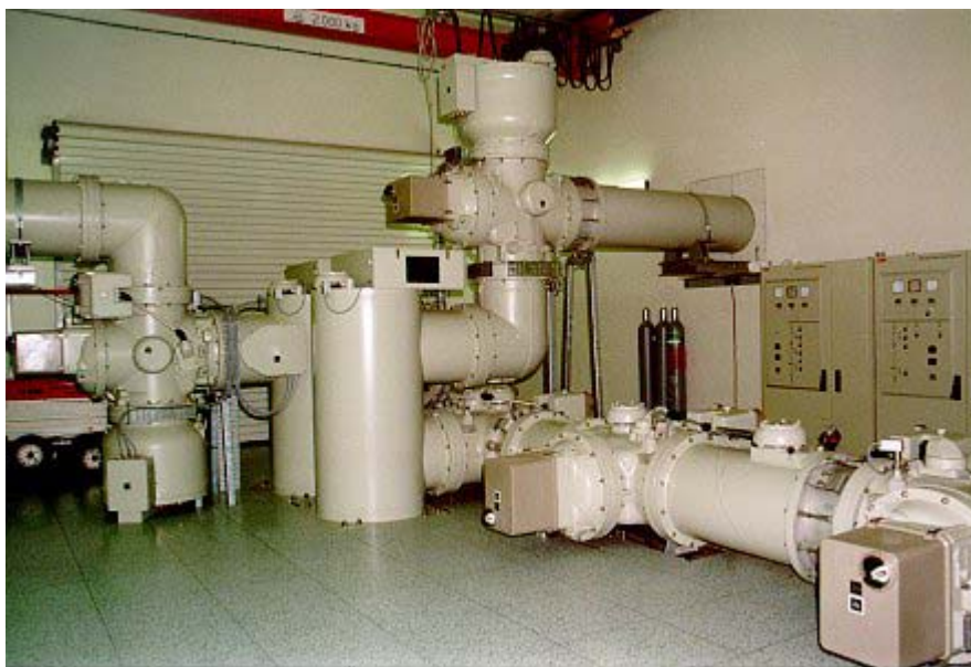
Zapouzdřená rozvodna firmy ABB 110 kV v TT Svitavy
