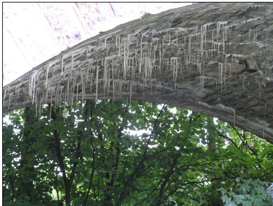
Obr. 4: Průsak vody nosnou konstrukcí
