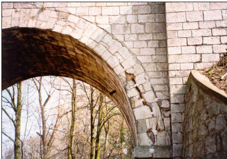
Obr. 5: Porucha mostního objektu v důsledku nárůstu intenzity dopravy
