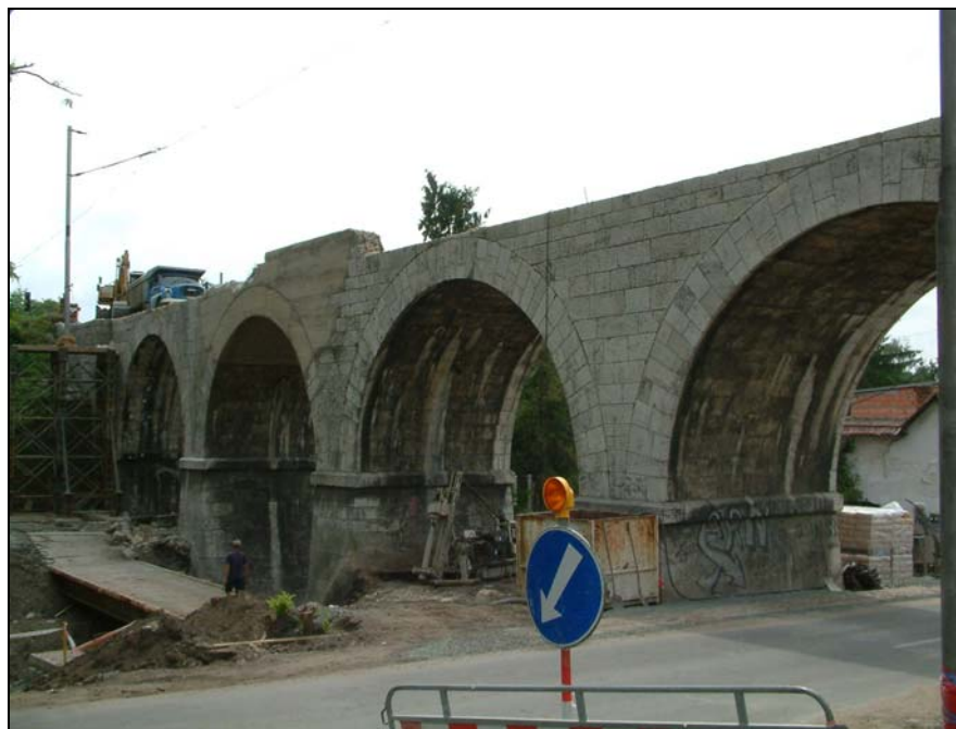
Obr. 7: Objekt s vážnými poruchami je nutno rekonstruovat
