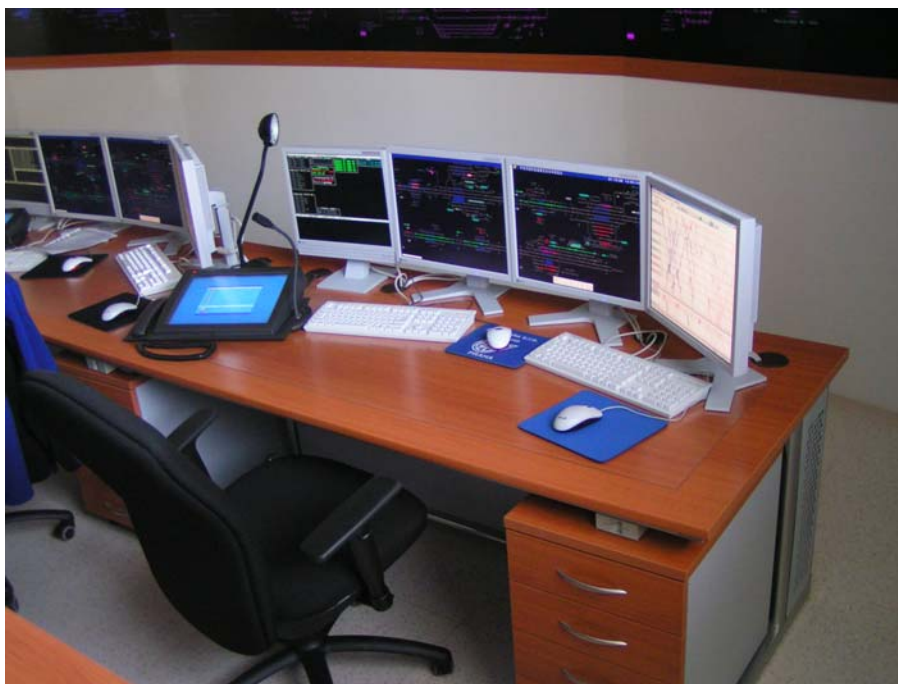
Obr.6: CDP Přerov, pracoviště dispečera dálkového ovládním
