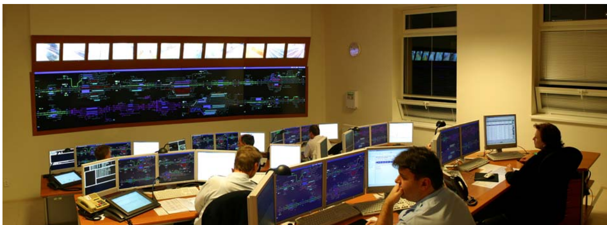
Obr.4: CDP Přerov, sál č. 1 – celkový pohled na pracoviště dispečerů a operátorů
