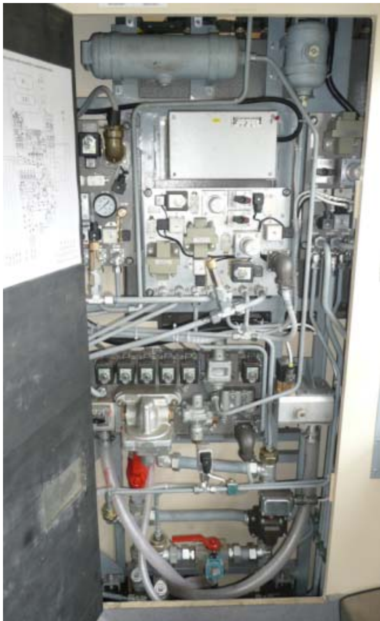
Obr. č. 4 – Vzduchový rozvaděč
