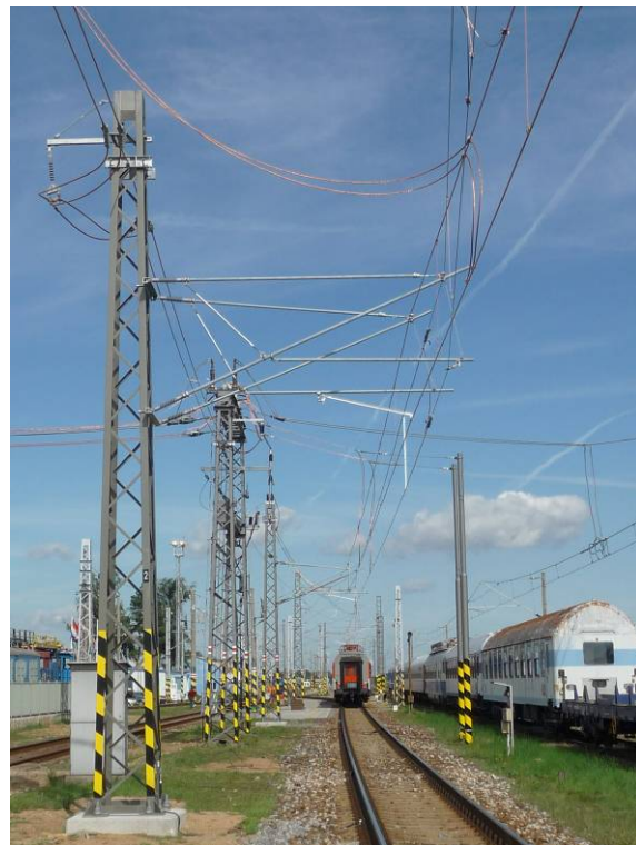
Obr. 5 Dokončené trakční vedení VZO
