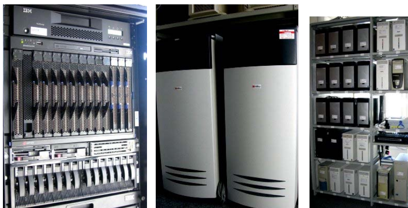
Obrázek 2: Serverová farma pro provozování klíčových informačních systémů, zleva: IBM Blade Center, záložní napájení (UPS), podsíť provozu nekritických aplikací
