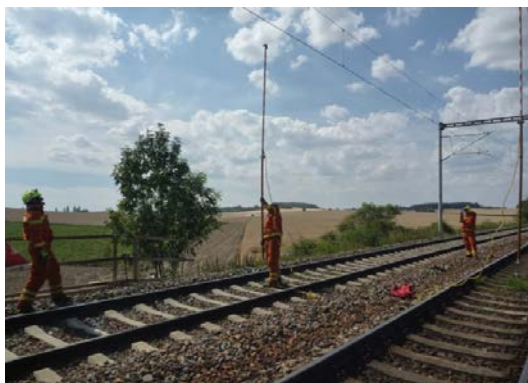
Obrázek č. 13 - Zkratování trakčního vedení
