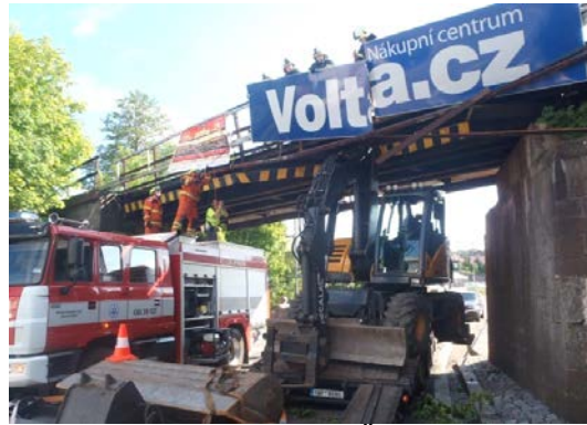
Obrázek č. 9 – Zaměstnanci JPO HZS SŽDC provizorně zajišťují potrubí
