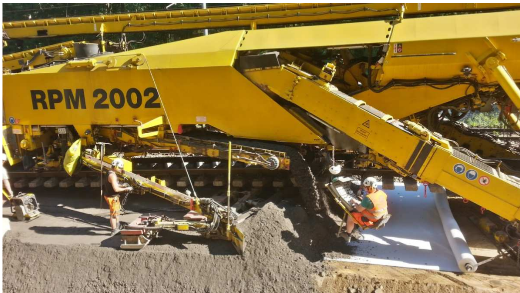
Obrázek 2 – Pokládka minerální směsi technologií bez snášení kolejového roštu strojem RPM 2002 na úseku Praha Běchovice - Úvaly
